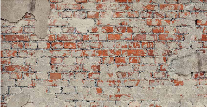
Esempio di supporto non adeguatamente ripulito
