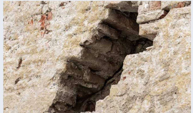
Esempio di lacuna muraria da ripristinare
