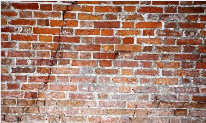
Esempio di muratura lesionata da ripristinare
